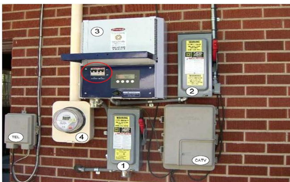
شکل (۳-۱۳): کلیدها و قطع کننده‌های سیستم فتوولتائیک ۱- قطع کننده AC، ۲- قطع کننده DC، ۳- مبدل همراه با کلید کلیدهای DC و AC و بر روی پانل مبدل با دایره قرمز رنگ مشخص شده است) و ۴- کنتور
